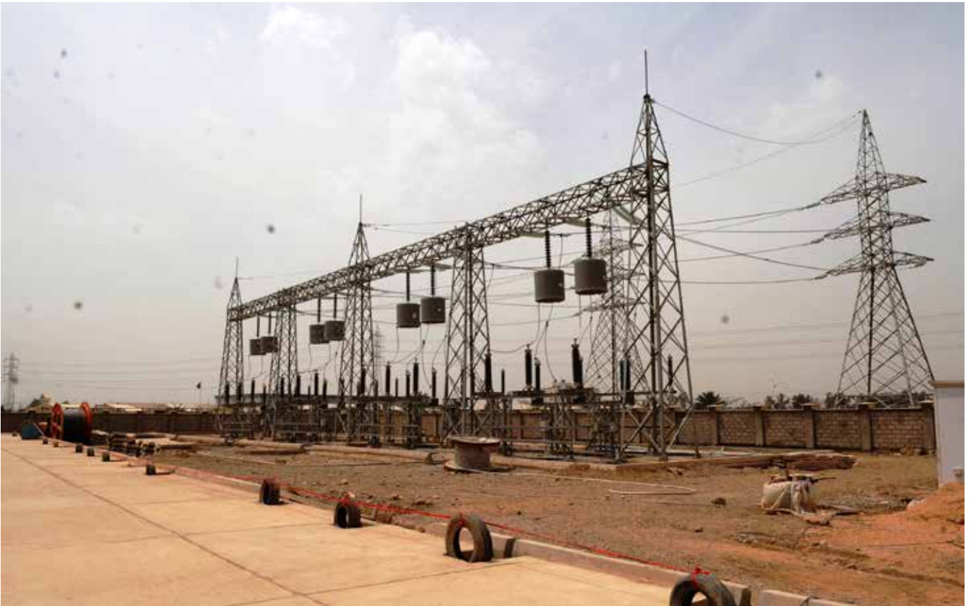
Nicht zuletzt die Stromversorgung bricht im Irak immer wieder komplett zusammen. Foto: James Selesnick / U.S. Army
